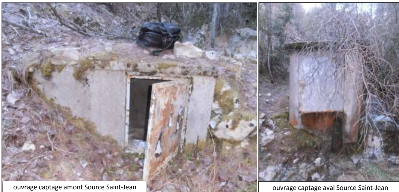
Figure 2 : ouvrages amont et aval du captage de la source Saint-Jean abandonnés et déconnectés du réseau AEP
